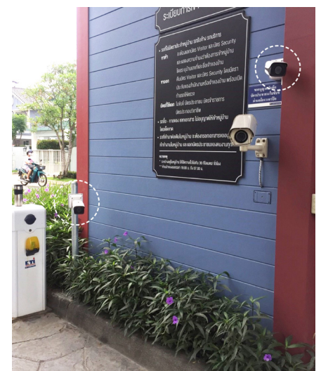
กล้องวงจรปิด ที่มาพร้อมเทคโนโลยีล่าสุด บันทึกข้อมูล รถเข้า-ออก ตั้งแต่ประตูทางเข้าจนถึงปลายทาง
